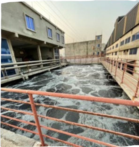
Foto de un sistema de tratamiento de aguas de uno de nuestros proveedores que participa en el proyecto Better Mill.
